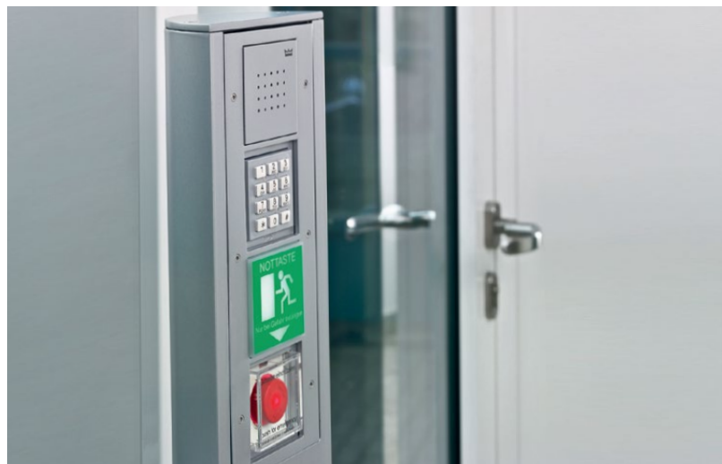
TMS-sikkerhetssystem for rømningsvei
